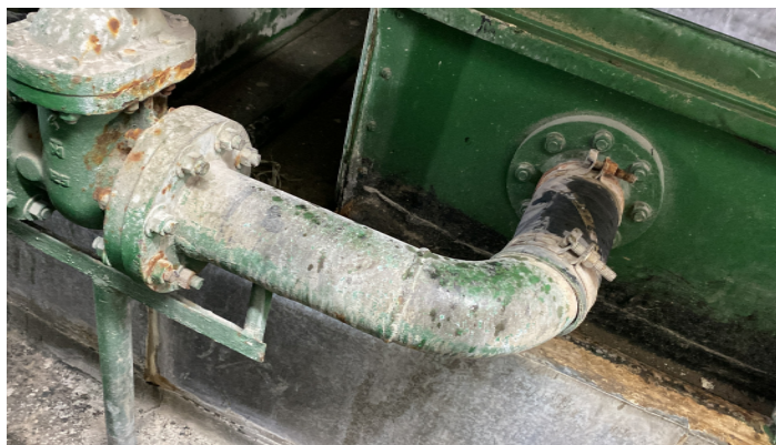
Imagem 36 - Tubulação com aspecto deteriorado, necessitará revisão.
