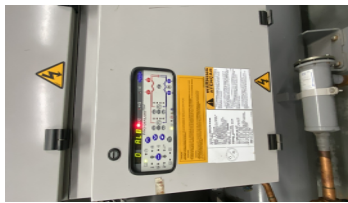
Imagem 41 - Painel IHM de controle de um dos Chillers.
