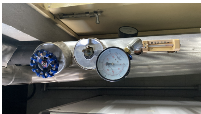
Imagem 46 - Manômetro e Termômetro analógicos e válvula manual no cavalete de água gelada do Fancoil.
