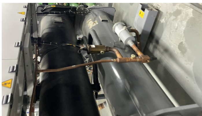
Imagem 29 - Foto de um dos chillers, detalhamento dos trocadores.
