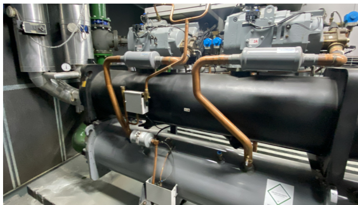
Imagem 28 - Foto de um dos chillers.
