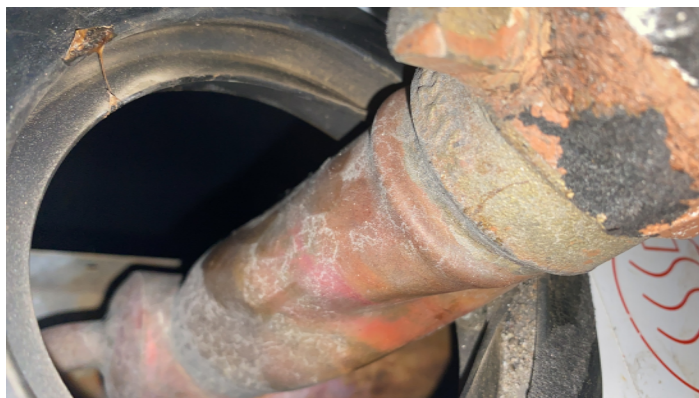
Imagem 9 B- Tubulação de cobre na entrada do Fancoil com presença de oxidação (azinhavre).
