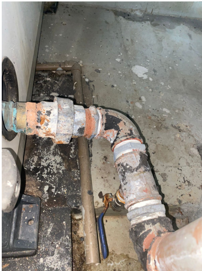
Imagem 21 - Tubulação do cavalete sem isolamento e apresentando fortes indicadores de corrosão.
