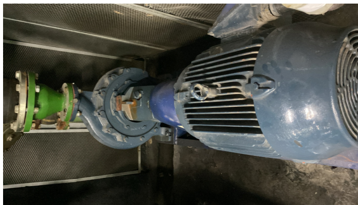
Imagem 25 - Bomba do Sistema de Água Gelada/Água Condensada.
