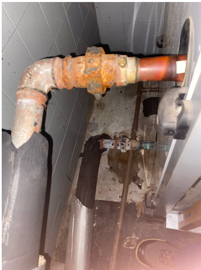
Imagem 19 - Tubulação do cavalete sem isolamento e apresentando fortes indicadores de corrosão.
