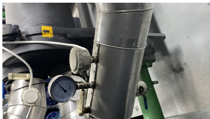
Imagem 44 - Manômetro analógico e PT100 (Sensor de Temperatura) do sistema de água gelada conectado ao Chiller.
