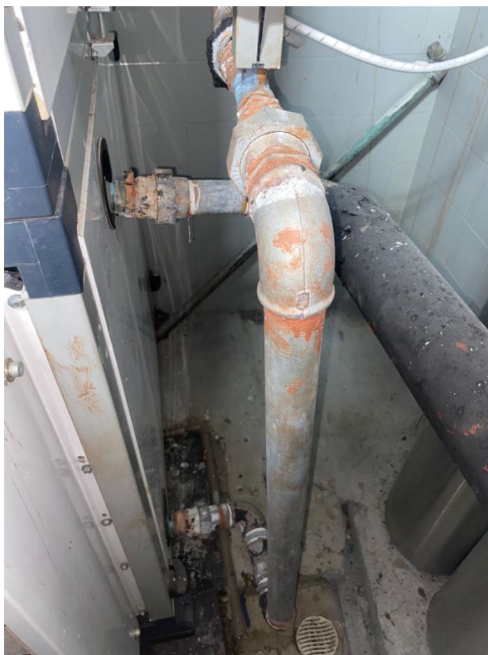
Imagem 20 - Tubulação do cavalete sem isolamento.
