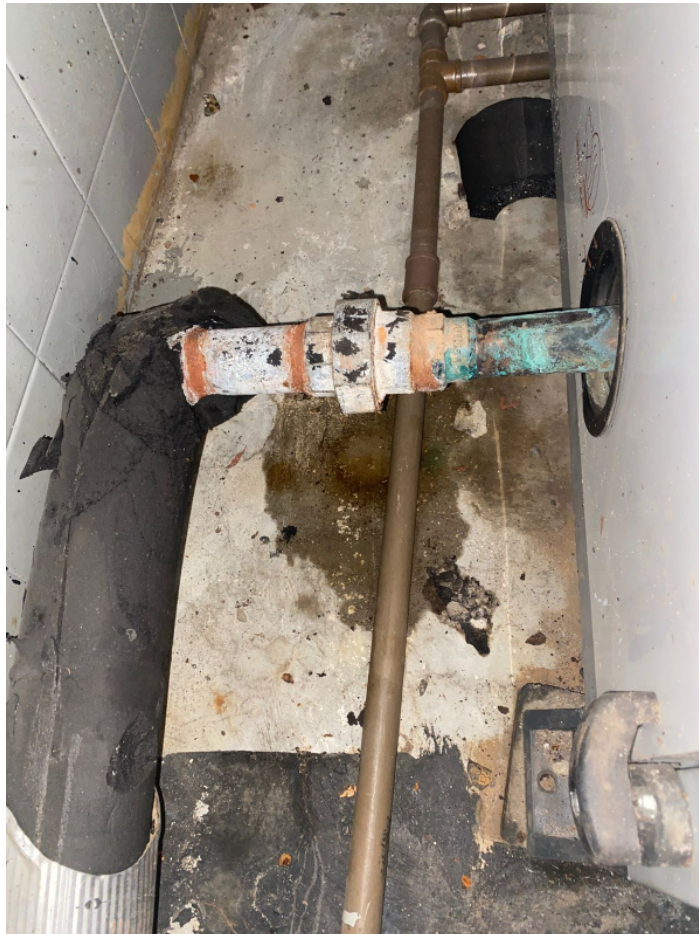
Imagem 9 A- Tubulação de cobre na entrada do Fancoil com presença de oxidação (azinhavre).
