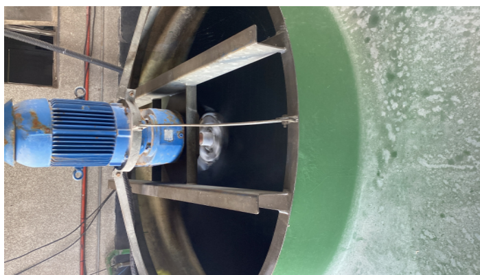
Imagem 31 - Conjunto Moto-ventilador de uma das Torres de Resfriamento.
