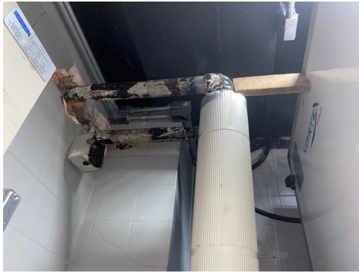
Imagem 23 - Tubulação do cavalete sem isolamento.
