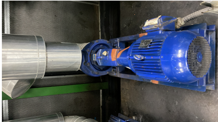
Imagem 24 - Bomba do Sistema de Água Gelada/Água Condensada.
