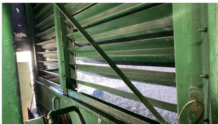
Imagem 35 - Aletas de captação do ar.
