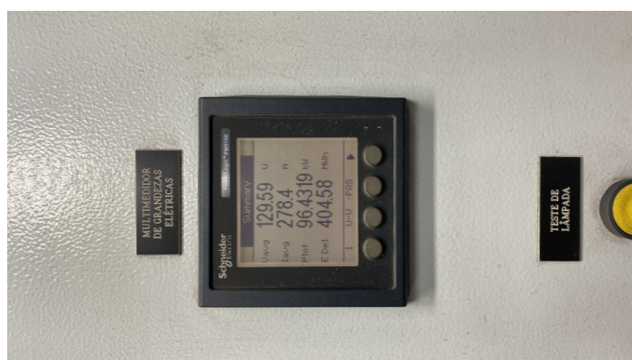
Imagem 51 - Monitoramento do Painel Elétrico do sistema
