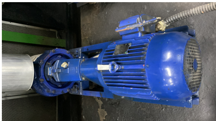
Imagem 25 - Bomba do Sistema de Água Gelada/Água Condensada.
