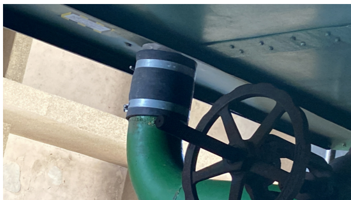
Imagem 34 - Conexão adaptada de entrada do sistema de água água condensada nos chuveiros da torre. Detalhe para a conexão improvisada realizada para atender à correção de falha.
