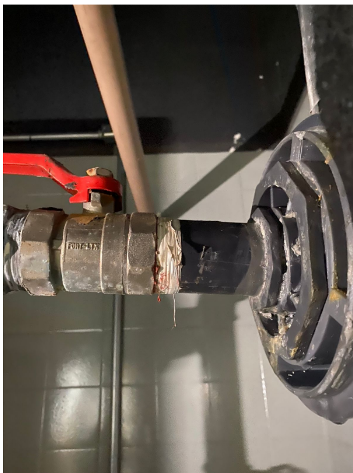
Imagem 17 - Conexão cavalete/prumada com problema de
