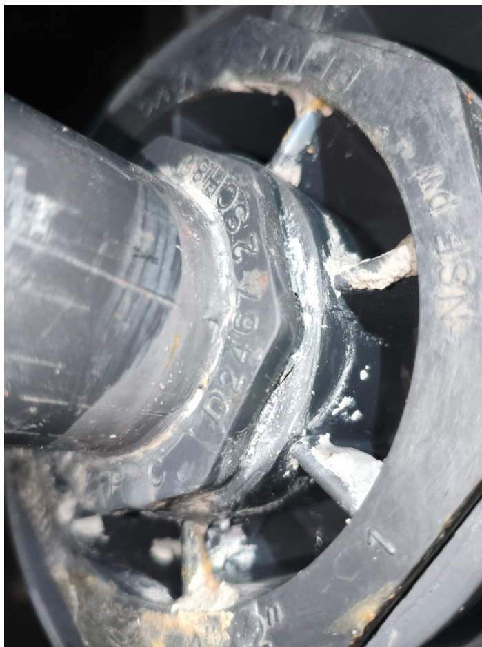
Imagem 16 - Local onde houve ruptura e vazamento, na conexão da luva e flange de PVC-U (conexão cavalete/prumada Fancoil 2A).
