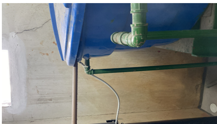
Imagem 39 - Tanque de Compensação do Sistema de Climatização.
