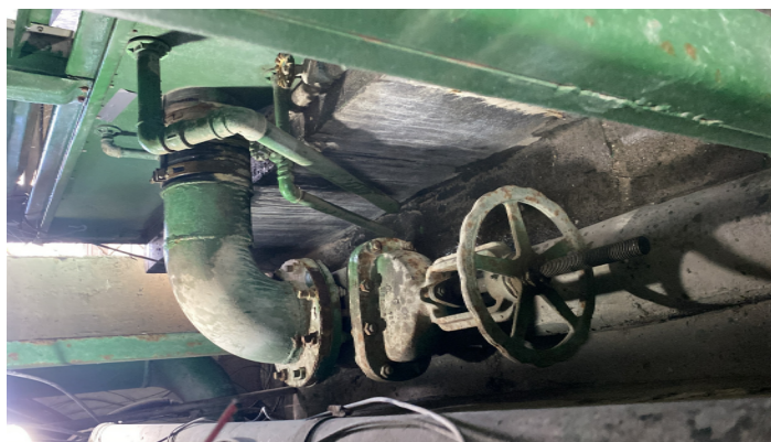
Imagem 38 - Saída da tubulação de água condensada da Torre de resfriamento.
