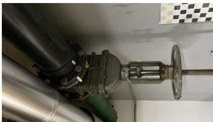
Imagem 13 - Passagem de prumada com válvula
