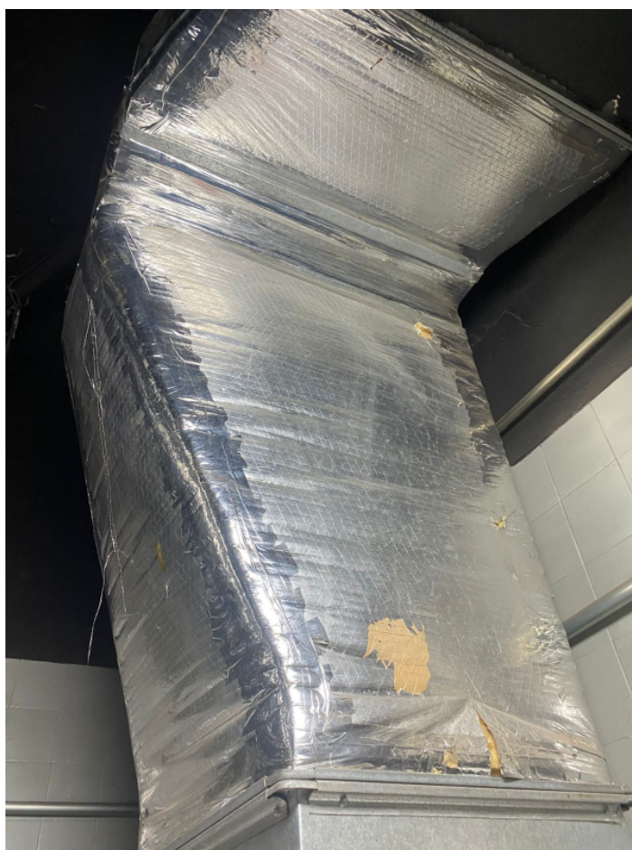
Imagem 10 - Duto saindo do Fancoil com pequenos danos na manta.
