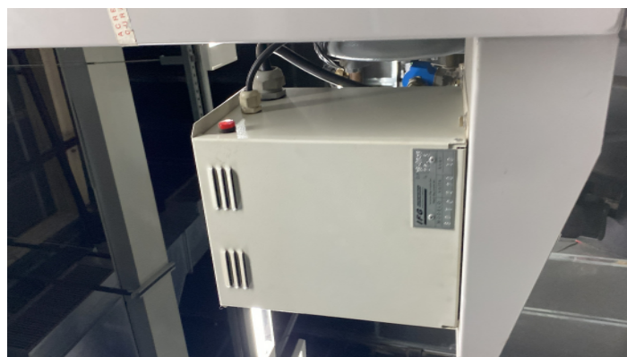
Imagem 50 - Sistema de Acionamento do Chiller.
