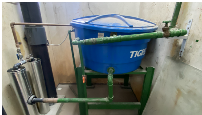
Imagem 40 - Tanque de Compensação do Sistema de Climatização.
