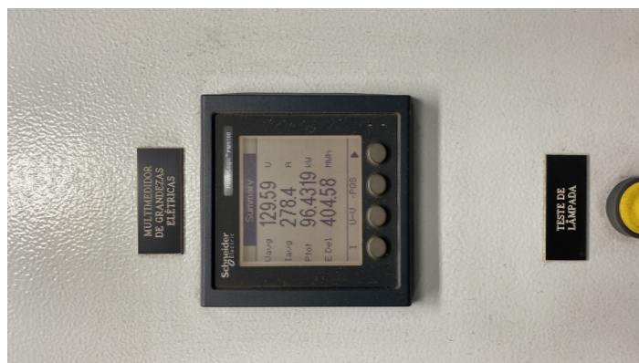
Imagem 45 - Monitoramento do sistema elétrico.
