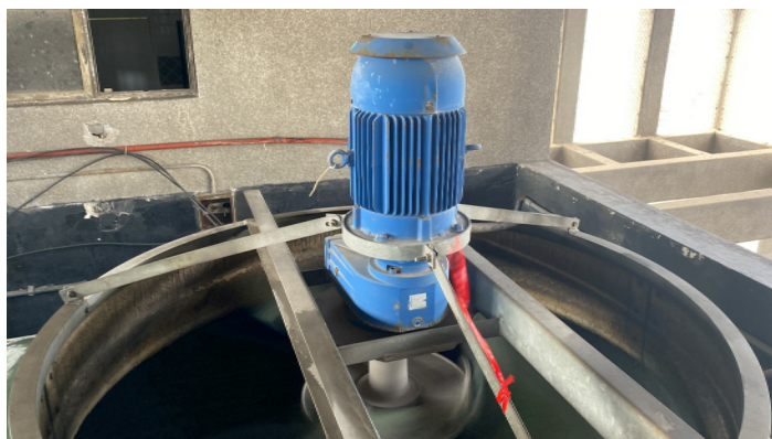
Imagem 32 - Conjunto Moto-ventilador de uma das Torres de Resfriamento.
