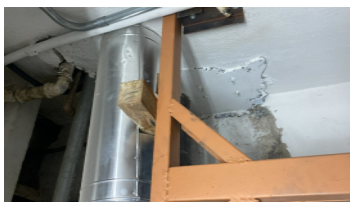
Imagem 18 - Apoios das prumadas em situações críticas.
